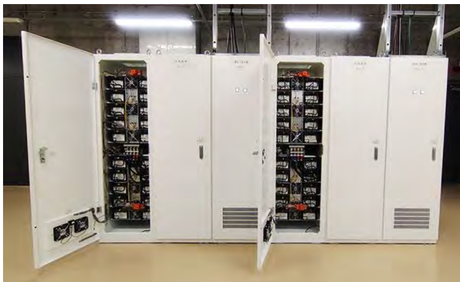
えきまちエナジークリエイトに導入された蓄電システムとリユース電池
